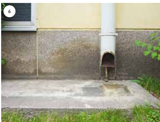
Ensimmäisen kerroksen ikkunat alkavat sokkelin yläpinnasta. Sokkelissa on pesubetonilaatat. Osa syöksytorvista on alkuperäisiä ja niiden edustalla maassa on betonikouruja.
