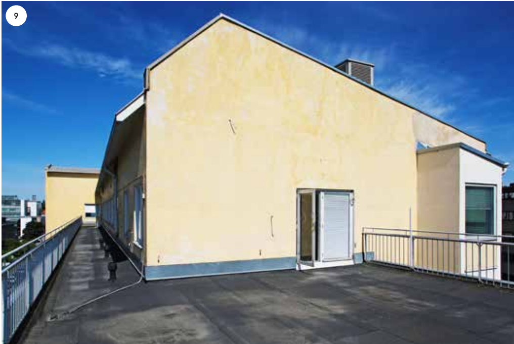
Kuudennen kerroksen kattoterassin eteläpääty on alun perin ollut laitoksen johtajan käytössä, sillä hänen asuntonsa sijoittui rakennuksen viidennen ja kuudennen kerroksen eteläosaan. Nykyisin kattoterassilla ei enää ole laatoituksia vaan katolla on bitumihuopa, jota on paikkailtu. Teräksistä pystypinnakaidetta on korotettu. Terassille pääsee ikkunaoven kautta.
