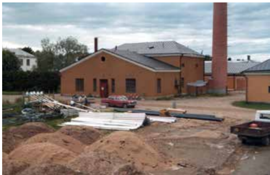
Sairaala-alueen valaistus uusittiin vuosina 1978-79. Samaan aikaan tiet asfaltoitiin. Valaistustyömaan takana näkyvä teknisen huollon rakennus on sittemmin muutettu rappaukseltaan vaaleammaksi. (Tekninen huolto, Niuvanniemen sairaala)
