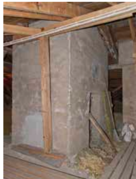
300 c Ullakko. Alkuperäinen ilmanvaihtojärjestelmään kuulunut imupiippu.
