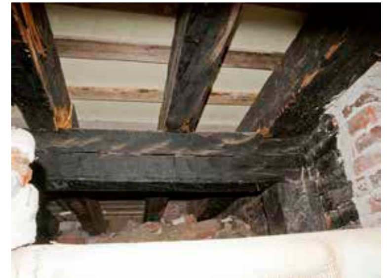
Alkuperäisiä puupalkkeja, veistopinta. Yläpuolinen uusittu rakenne tukeutuu alkuperäisiin palkistoihin. Hirsien alkuperäinen pintakäsittely sisältää haitta-aineita.
