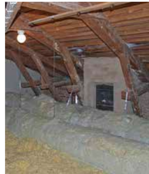
300 c Ullakko. Alkuperäinen ilmanvaihtojärjestelmään kuulunut imupiippu.
