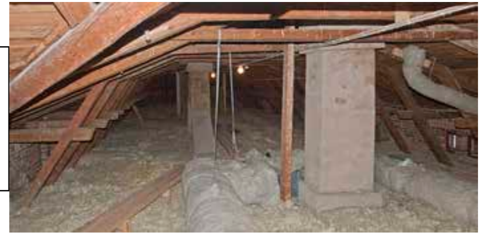
300 I Ullakko. Vesikaton runkorakenne ja säilyneet piiput ovat alkuperäisiä. Mineraalivilllaeristys ja IV-kanavisto 1990-luvulta.
