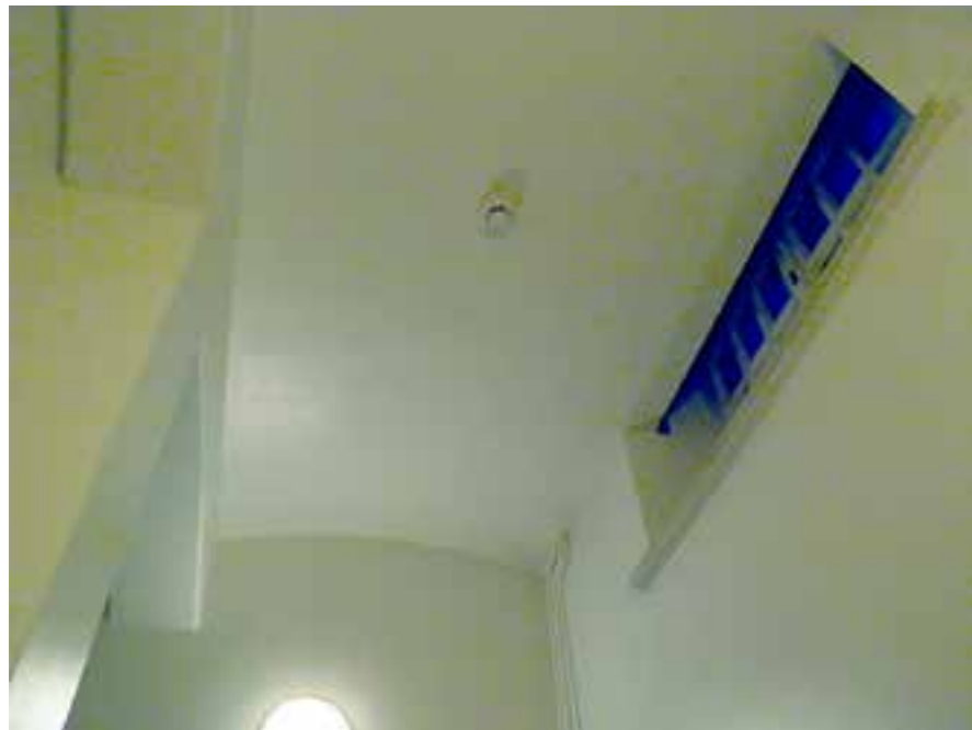
Holvauksia porrashuoneen katossa.
