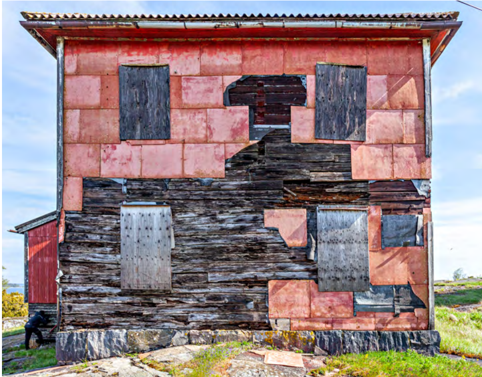
Luotsituvan lounaisseinällä mineriitti levyt ovat irtoilleet ja hirsirunko on pahasti lahonnut.
